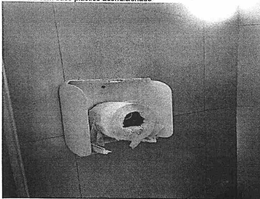
Foto 11 - Vista parcial de sanitário masculino de acesso gratuito mostrando papelaria danificada visto que não se vence fazer a troca das mesmas pois imediatamente são quebradas.
