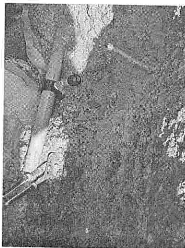
Foto do motivo do vazamento
