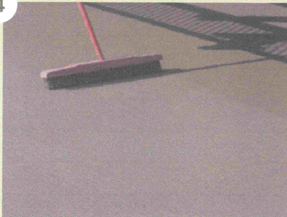
Para dar maior aderência ao concreto, evitando o escorregamento dos usuários, deve ser feita uma textura com vassoura de fios de piaçava ou náilon.
