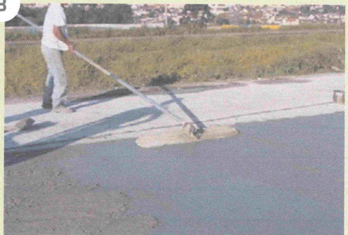
Nivelamento de superfície executado com auxílio de régua de corte e desempenadeira (floating) de cabo estendido e rótula.
