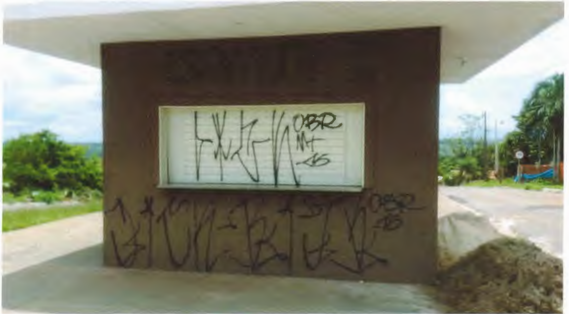
Pinchado e servindo de depósito
