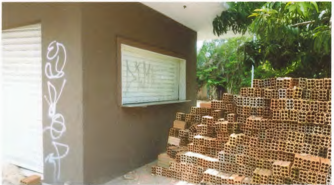
Pinchado e servindo de depósito
