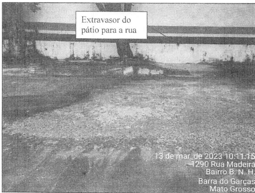
Imagem 03: Destaque para o tubo extravasador e detalhe dos sinais de extravasamento de água recente.
